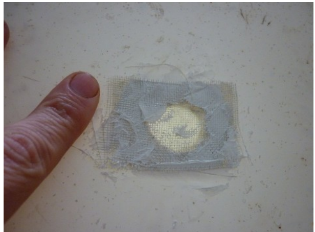
XXXX Photo A30 : Entrée d'air grillagée par une trame en nylon collée avec du mastic.
